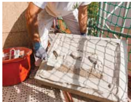
Geübte Praxis: Hanfdämmplatten von Caparol werden nach der Wulst-Punkt-Methode mit Armiermörtel versehen, ...
